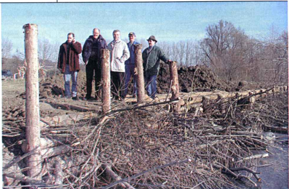
Bei der Besichtigung der Baustelle (v.l.n.r. HR DI Czeiner, Bauführer Timpel, LAbg. Bgm. Jahrman, Hr. Mayer, gGR Zöchbauer
