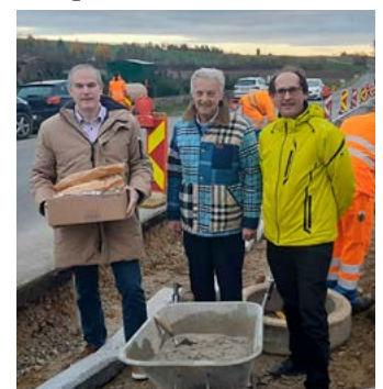
vlnr: STR Josef Keck, BGM Alfred Babinsky, Andreas Leeb besuchen die Baustelle in Sonnberg.
